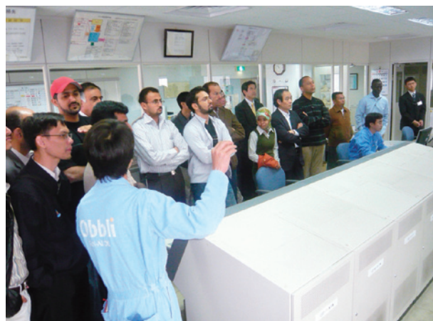
三愛石油(株) 羽田支社 コントロール室にて
